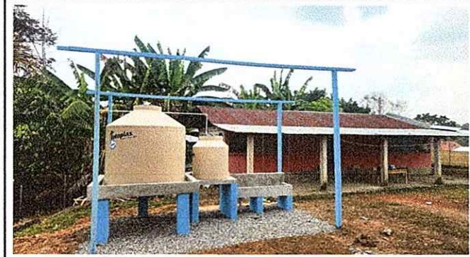
Foto 1: Cubierta de Lamina sobre lava manos
