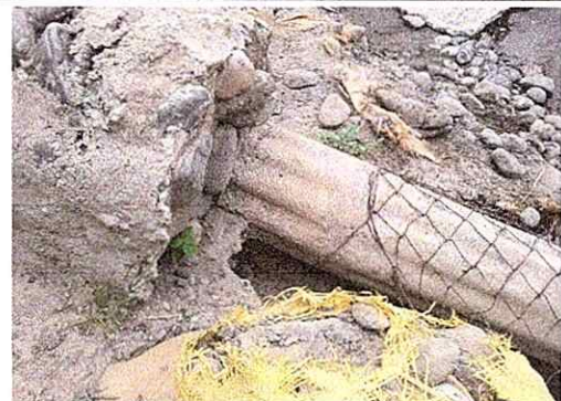
Foto 2: Muro perimetral en mal estado
